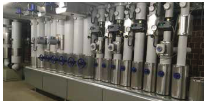
Der erneuerte Heizverteiler im Hauptgebäude des KBSZ Aalen
