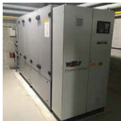
Installiertes BHKW im KBSZ Aalen
